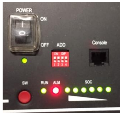
Figura 69 - Stato della batteria dopo aver posizionato lo switch POWER su ON ed aver premuto il tasto SW
