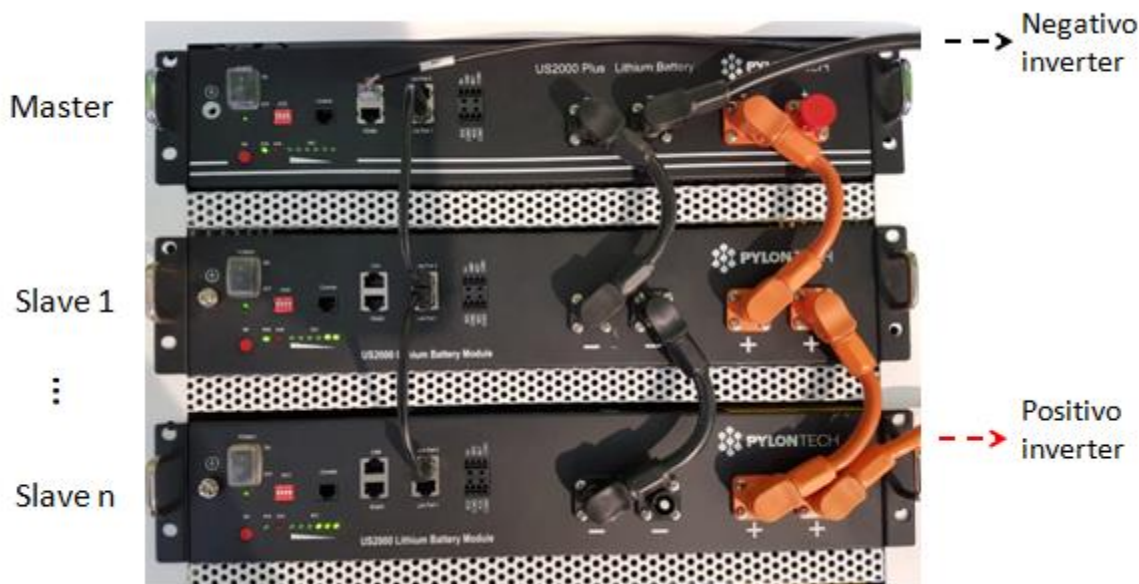
Figura 10 - Parallelo di tre batterie Pylontech
