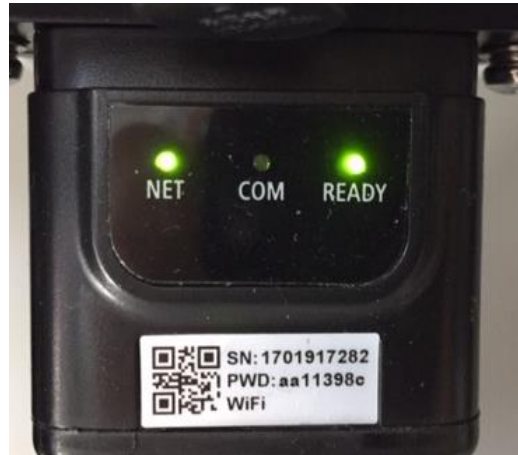
Figura 103 - Stato di comunicazione irregolare tra inverter e scheda
